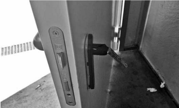
Zerstörungswut im P & R-Gebäude
