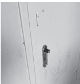
Zerstörter Türgriff (P & R, 4. OG)
