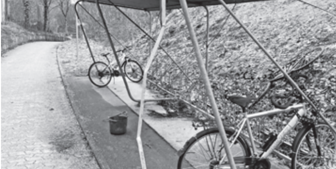
Beschädigung des Fahrradunterstandes
