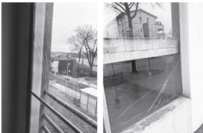
Glasbruch im 3. Stock (P&R-Gebäude)
