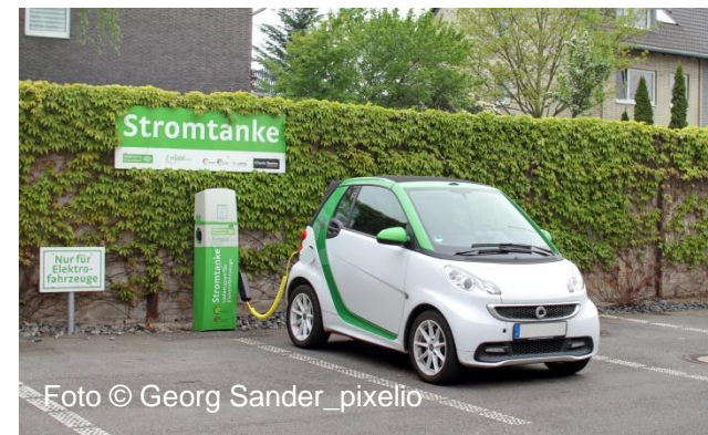
Ladestation für e-Fahrzeuge (Rad, Pkw)
