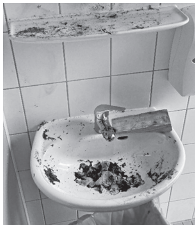
Aschereste und Brandspuren im Sanitär-raum der Turnhalle
