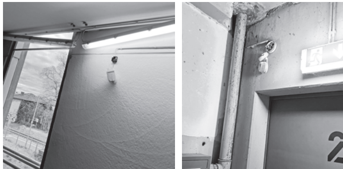
Schäden an den Bewegungsmeldern und der (Not-)Beleuchtung
